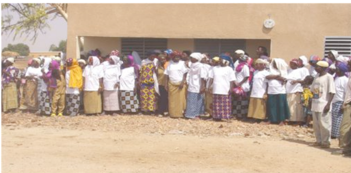
Les femmes amènent l'eau et le sable sur le chantier pour la construction de la savonnerie.
